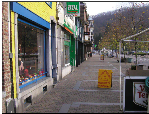
"Bricolage électrique" (à moins de 2 mètres au-dessus du trottoir) à supprimer
