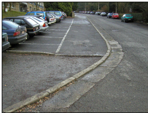
Bordures saillantes à rectifier
