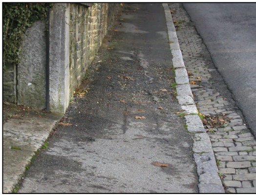
Asphalte fortement dégradé : à renouveler
