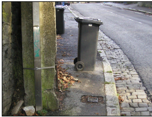
Poteau électrique à remplacer par un plus fin
